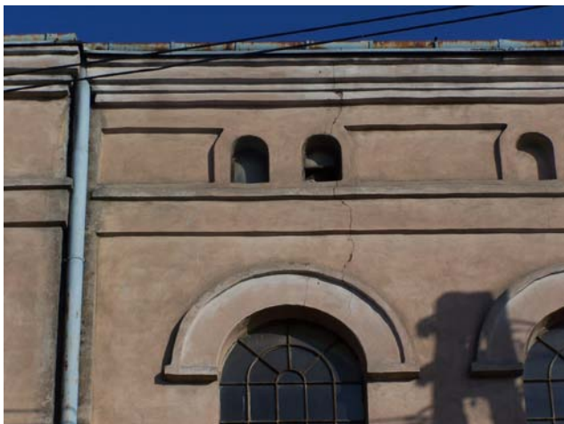
Oś nr 1". Pęknięcie gzyms-nadproże
